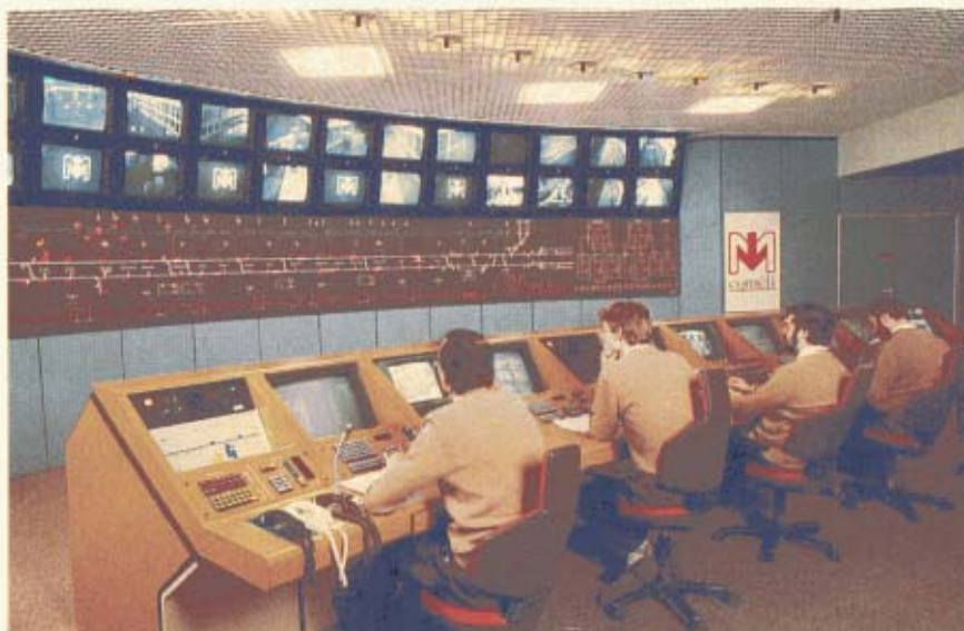
Le poste central de commandes est le cerveau du métro. 24 écrans de télévision permettent à cinq opérateurs de suivre toute l'évolution du trafic.
